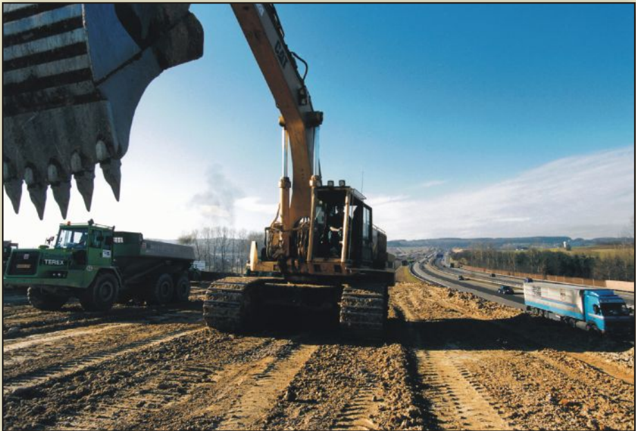
Verdichtung - eine Folge häufiger Befahrungen
