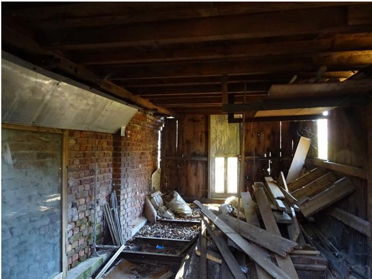
Foto 11: Kontrolle Schuppen (Einsturzgefahr) ohne Hinweise auf Quartiere oder akt. Besatz, 14.11.22.
