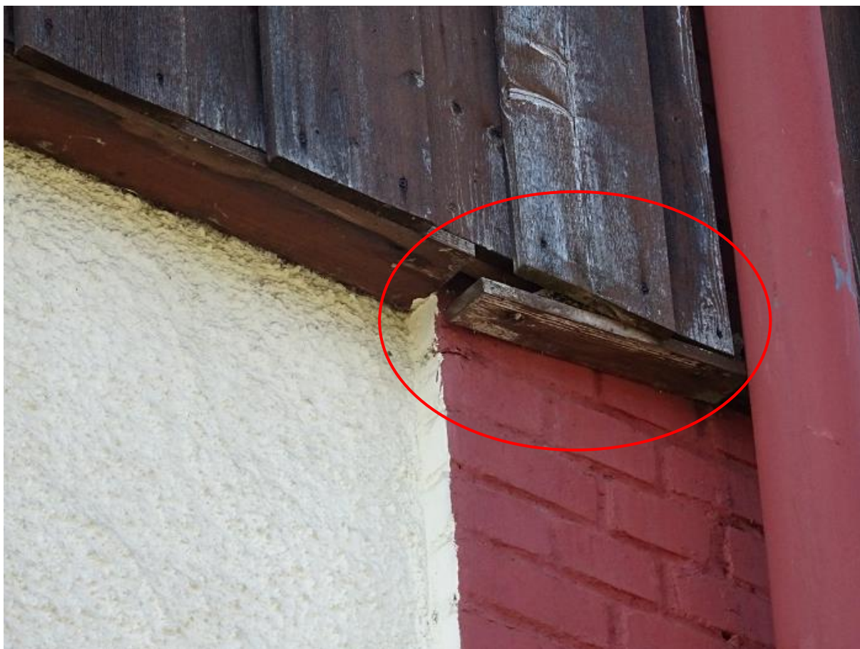
Foto 5: defekter Dachkasten Nordost-Seite Hauptgebäude mit Quartierpotenzial für Vögel und Fledermäuse (exemplarisch), 14.11.2022.
