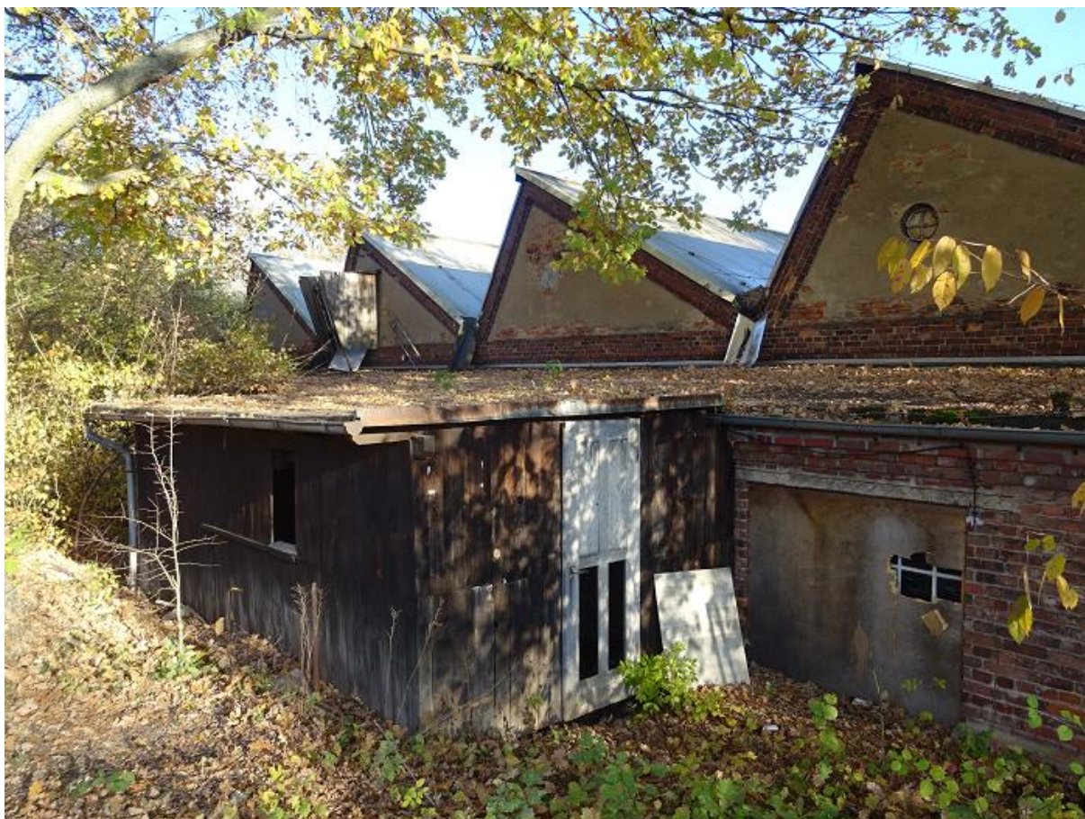
Foto 10: Südwestseite Hauptgebäude mit Schuppen und maroder Bausubstanz, 14.11.2022.
