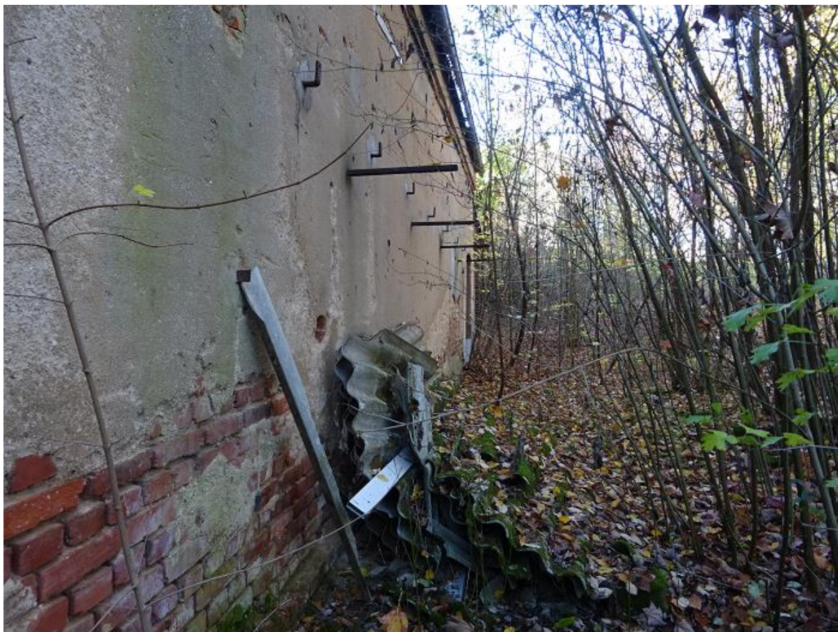
Foto 7: NW-Seite des Hauptgebäudes mit Haufwerk aus Bauschutt, 14.11.2022.
