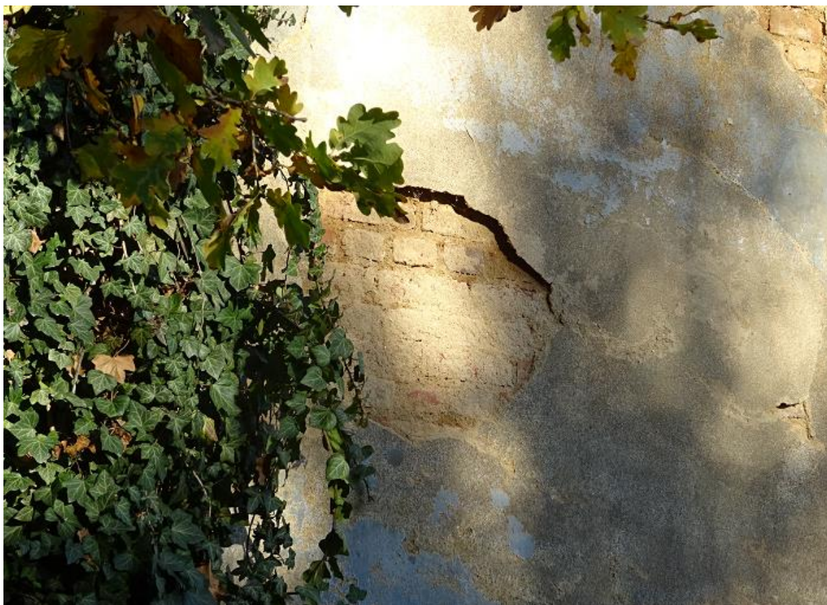
Foto 13: Fassade Südostseite Hauptgebäude mit sich lösendem Putz und somit potenziellem Spaltenquartier für Fledermäuse, 14.11.2022.
